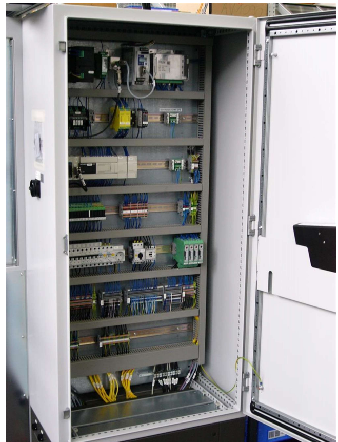
Bild 11: Geöffneter Schaltschrank eines Prüfstands
